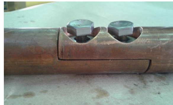
شکل ۳۶ اتصال کانداکتور های بالایی و پایینی پیش از سفت کردن پیچ ها Fig. 36 Bottom and top conductor before fastening the screws
