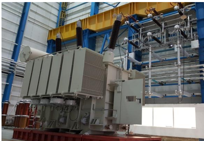
شکل ۱ نمایی از بوشینگ نصب شده روی ترانس
