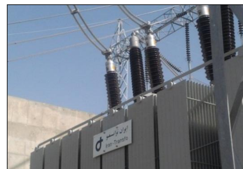
شکل ۲ نمایی از بوشینگ نصب شده روی ترانس در محل پست
