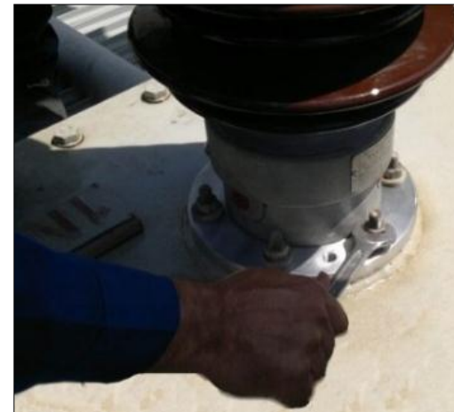
شکل ۴۰ بستن مهره های ناحیه اتصال فلنج بوشینگ به ترانس
