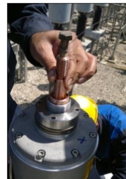
شکل ۳۹ عبور دادن سرکابل و کابل مسی افشان از داخل بوشینگ با استفاده از سیم کمکی Fig. 39 Using a helping wire to pass draw-lead and soldered cable through bushing
