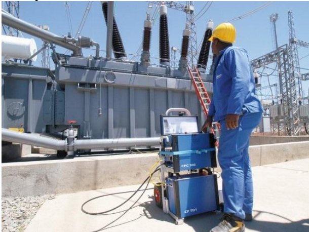
شکل ۶۱ تست‌های الکتریکی روی بوشینگ در محل پست با استفاده از دستگاه مخصوص
