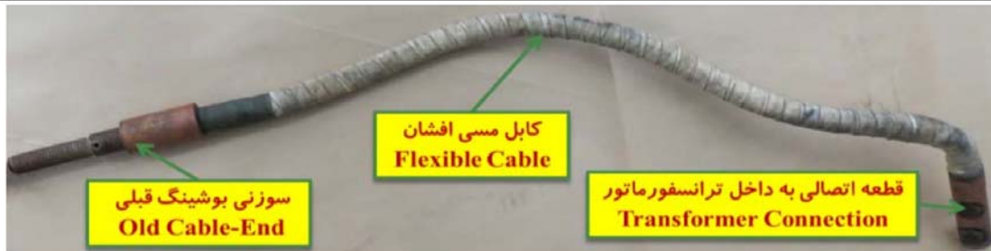
شکل 23- جزئیات سرکابل مسی قدیمی
